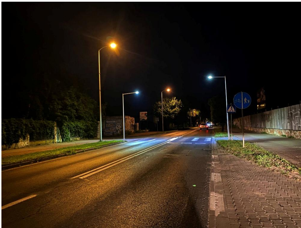
Oświetlenie przejścia dla pieszych, ul. Zielonogórska w Nowej Soli
